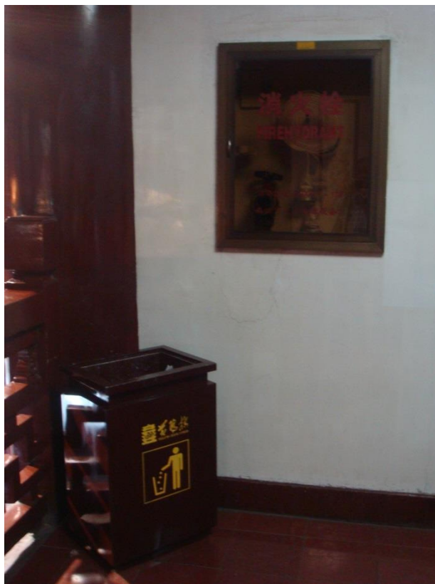
圖 12：黃鶴樓古蹟設置消防設施，彰顯遊客與古蹟安全的重要性。
