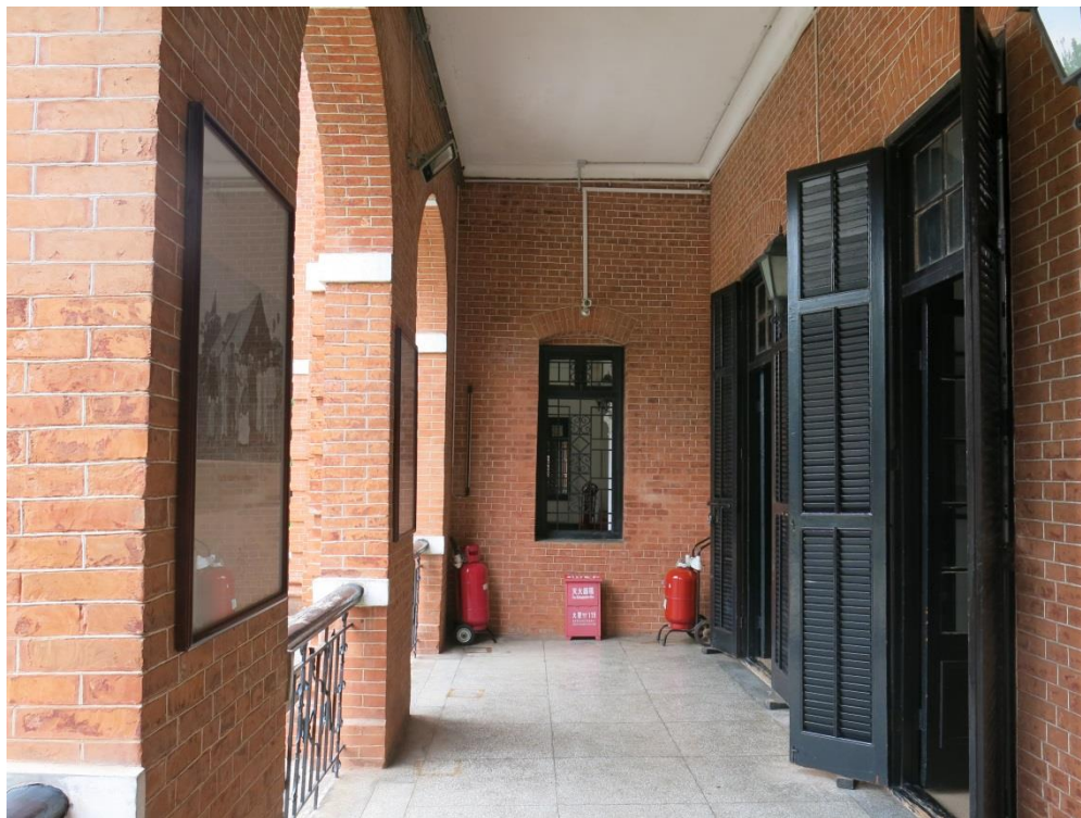
圖 15：辛亥革命武昌起義紀念館消防器材鋼瓶配置推車設置。
