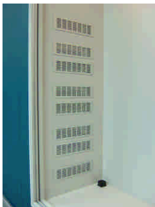
展櫃內的排濕口須加裝面材，以呈現展櫃之整體意象
