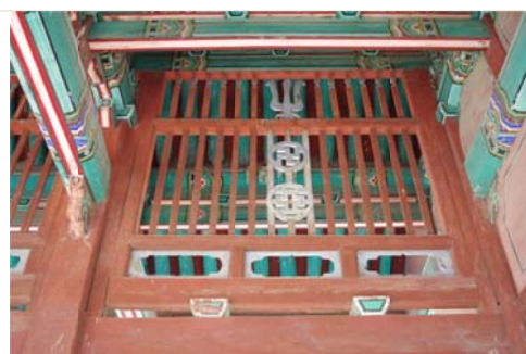
慶基殿內建物之相同部位，除三叉戟外，其下並飾有卍字文、亞字紋。
