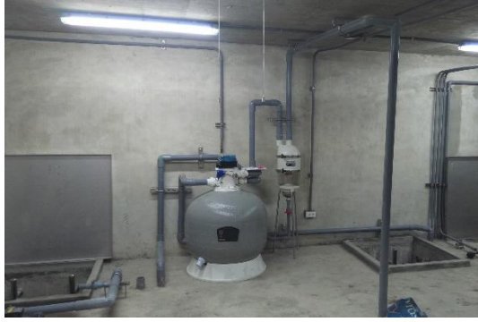
a. 地下雨水機房
