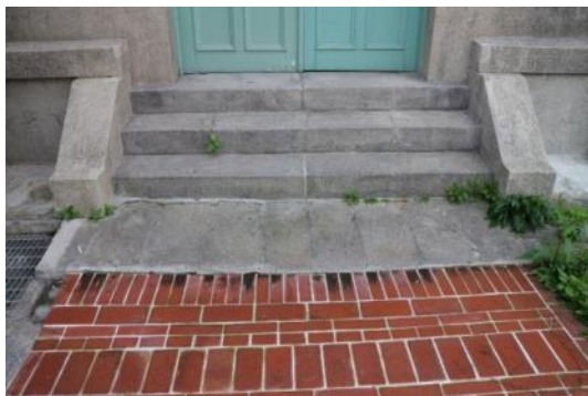
f. 廳舍北側後門階梯前古蹟地坪下陷，紅磚面須配合下凹，以切溝方式排水
