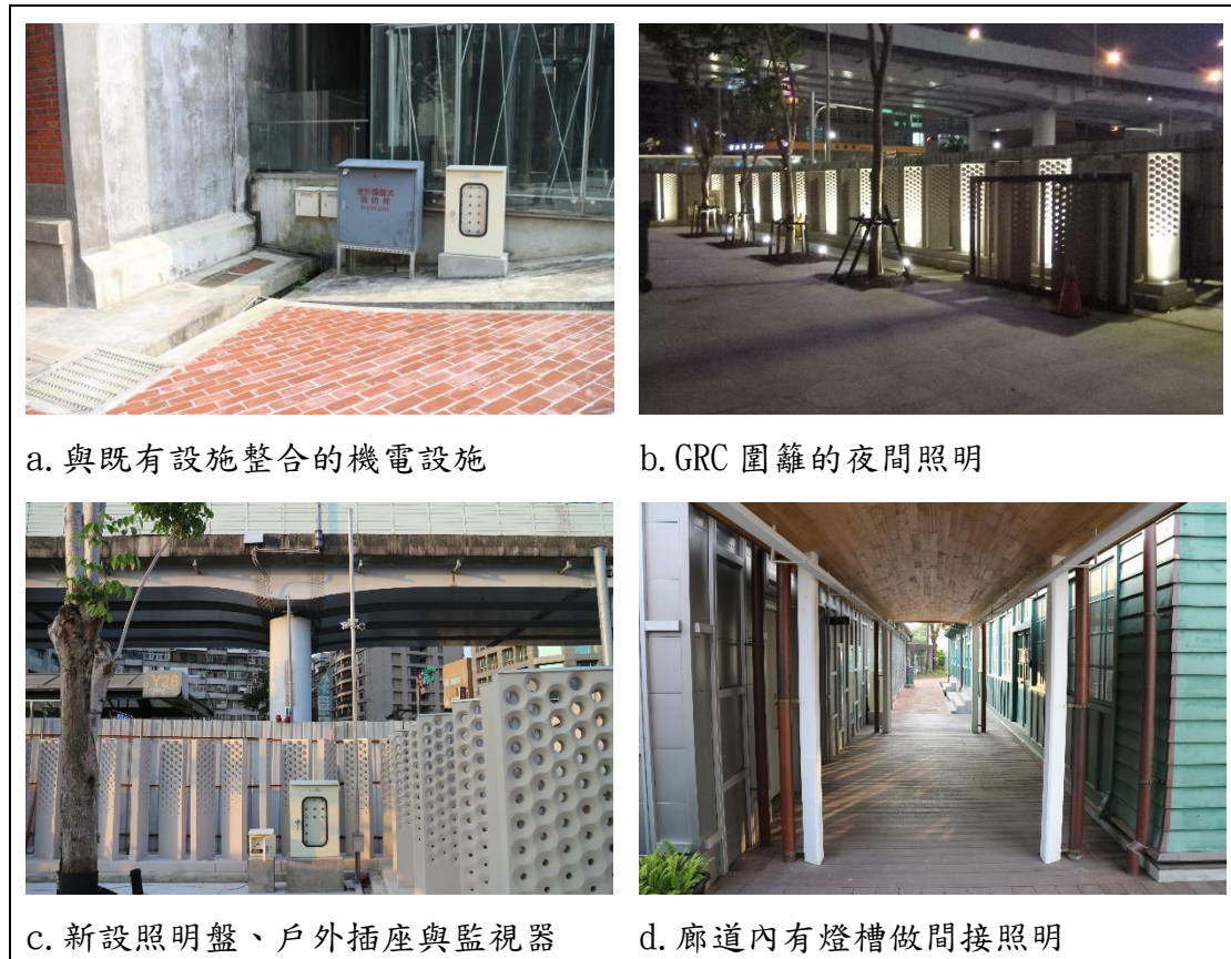
【圖 9】照明與機電設施
